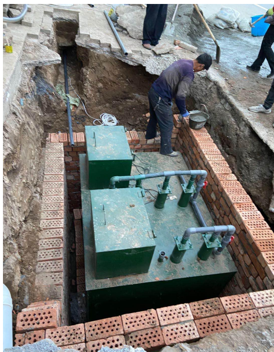
一体化处理设施
